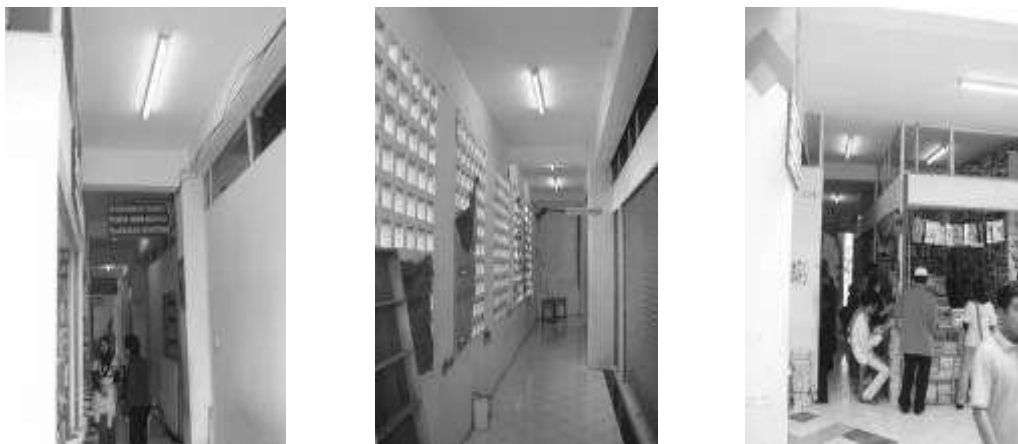
Gambar 5. Kondisi dinding dan plafon Toko Buku Shopping
